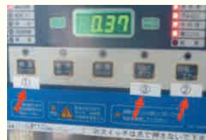
写真3 機械の作動パネルに番号をつけて操作手順をラベルシールで表示
